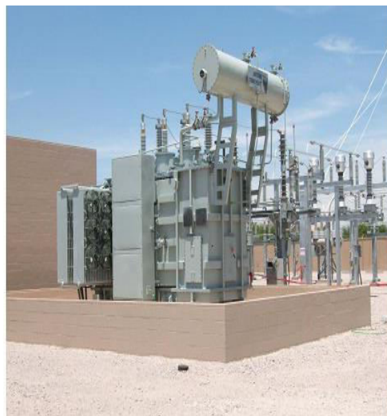
Fig. 1. Transformer Actual View
